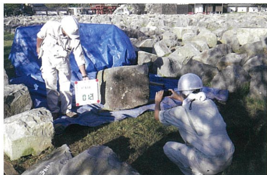
写真7 回収して仮石置場に並べられた崩落石材
