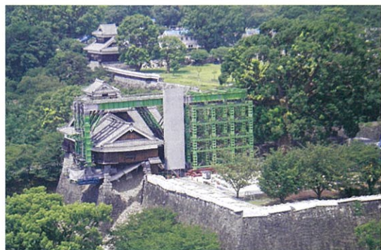
写真8 緊急的な倒壊防止対策（飯田丸五階櫓）
