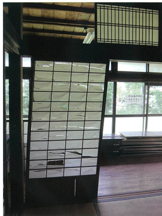
写真1(上) 川尻公会堂被災時外観 写真2(下) 同・建具の残留変形(変形角の生き証人)
