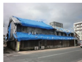
熊本地震で被災した町屋
