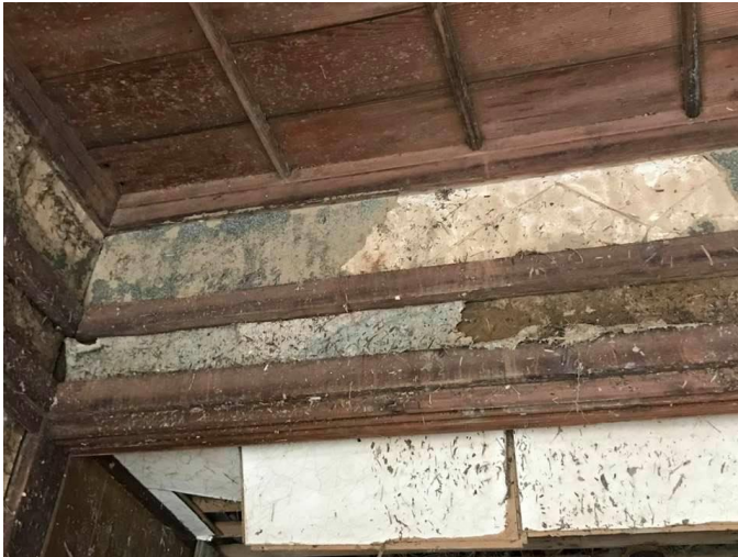
天井の上まで浸水した
