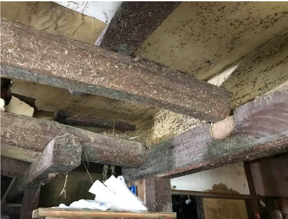
梁が浮き上がりはずれている
